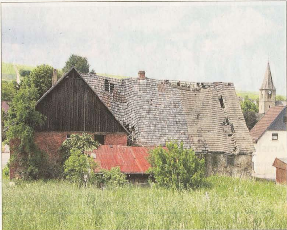
Mittlerweile schlägt das Dach von Strackenhof bedrohliche Wellen. Die Interessengemeinschaft will sich weiterhin für die Rettung des alten Hauses einsetzen. Foto: Zappe
