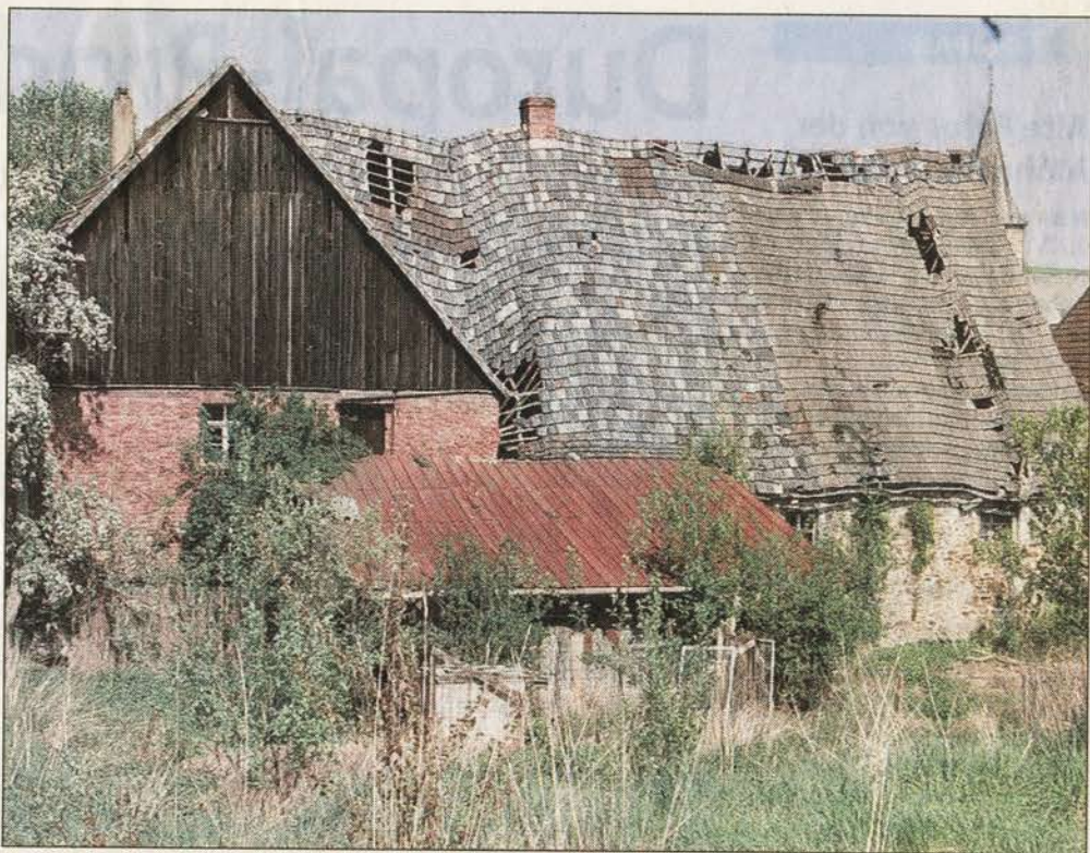
Für „Strackenhof“ läuft die Zeit. Mit jedem Monat, der vergeht, entstehen mehr Schäden an dem ältesten Steinhaus im Kurkölnener Sauerland, das im Dreißigjährigen Krieg gebaut wurde. Foto: Schäfer
